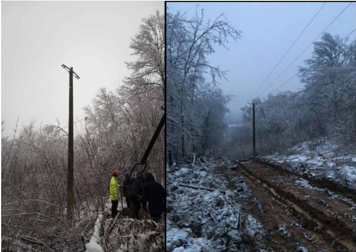
Slika 5. Pogledi na rešenje kvara na dalekovodu 35 kV TS 35/10 kV/kV „Gadžin Han“ – TS 35/10 kV/kV „Dušnik“
