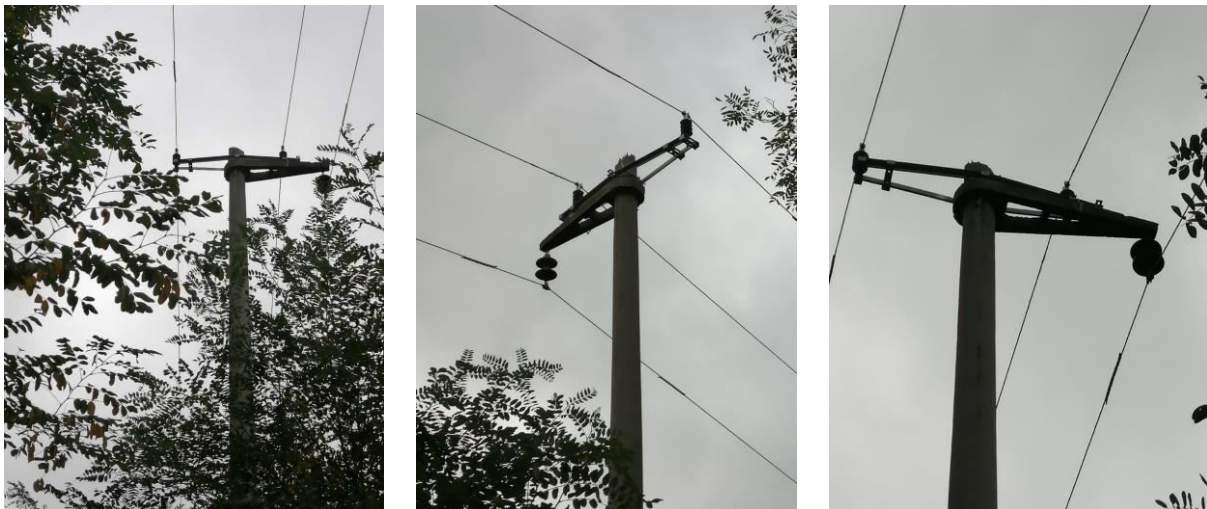
Slika 1. Pogledi iz tri ugla na rešenje kvara na dalekovodu 35 kV TS 35/10 kV/kV „Djuro Salaj“ – TS 35/10 kV/kV „Gadžin Han“
